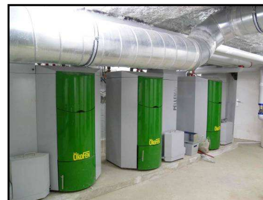
CHAUFFERIE DU FJT
